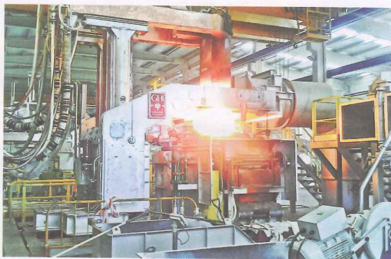
Horno de GHI, ingeniería que ha elevado la eficiencia de la mexicana Frasca Alloys.
